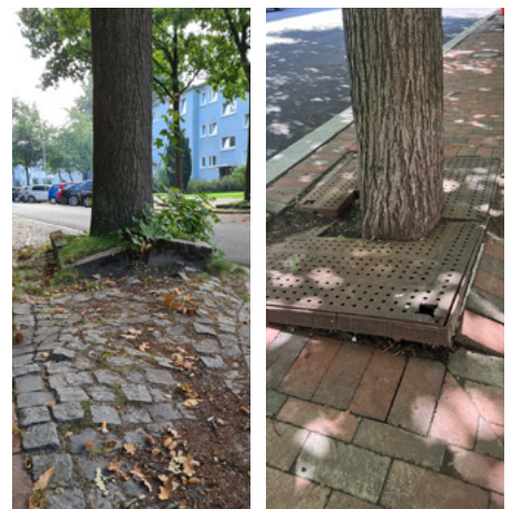
Wurzelhebungen können zu Problemen bei der Verkehrssicherheit führen.
