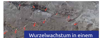
Wurzelwachstum in einem neuen Kanal, nach einer Wachstumssaison.
